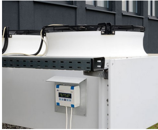
Commande de chauffage/climatisation/ventilation
